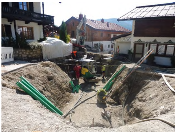
Abbildung 1: Die Bauarbeiten zum Hochwasserschutz in Reit im Winkl erreichen die nächste Etappe in der Hausbergstraße: Gebaut wird jetzt im Abschnitt zwischen Hausbergstraße 7 und 15. Foto: Wasserwirtschaftsamt Traunstein
