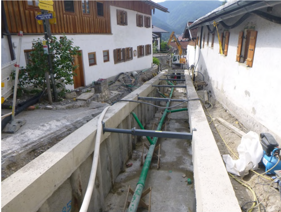
Abbildung 2: Weil der Platz im Bereich Hausbergstraße 3 bis 7 in Reit im Winkl sehr knapp ist, mussten sowohl die Häuser als auch der Baugraben selbst besonders gesichert werden. Stahlrohre und Beton sorgen für Stabilität. Foto: Wasserwirtschaftsamt Traunstein
