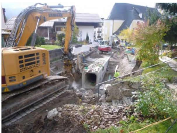
Abbildung 1: Der neue Hochwasserkanal, hier in der unteren Hausbergstraße bereits verlegt, ist wesentlich leistungsstärker als der alte. Er besteht aus Beton-Fertigteilen, die ineinander gesetzt werden. Foto: Wasserwirtschaftsamt Traunstein
