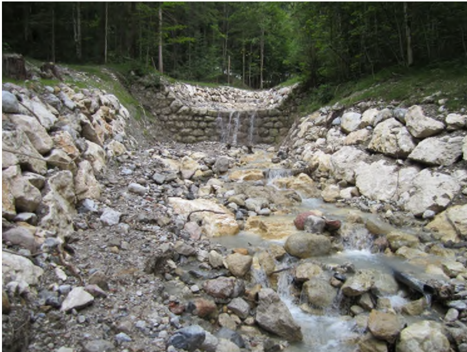
Abbildung 2: Der Klingerbach unterhalb der Bob- und Rodelbahn in Schönau am Königssee hat ein neues Bett und eine neue Ufersicherung bekommen. Auf rund 400 Metern hatte das Unwetter sämtliche Schutzvorrichtungen zerstört.
