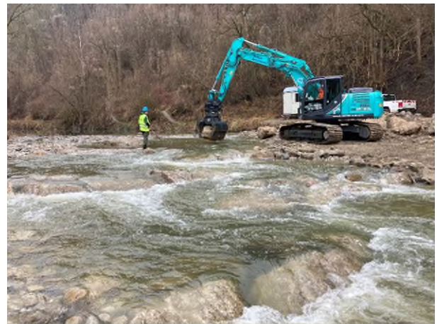
Abb. 2: Isen bei Steinhöring während Bauarbeiten mit Bagger: Ein Bagger setzt die Steine um. Wasserbau-Azubi Philipp Wallner-Mayer dirigiert die Arbeiten. Foto: Wasserwirtschaftsamt Traunstein
