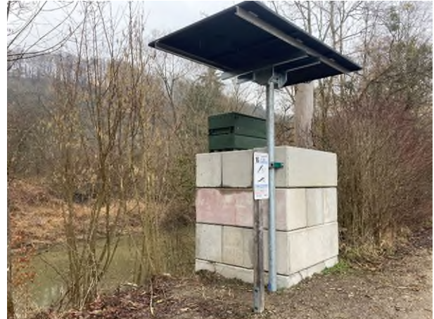
Abb. 4: Fischzählanlage: In dem Betonwürfel mit kleiner Solaranlage verbirgt sich die Technik für eine Fischzählanlage. Der Würfel steht direkt an der Aufstiegshilfe für die Fische. Foto: Wasserwirtschaftsamt Traunstein
