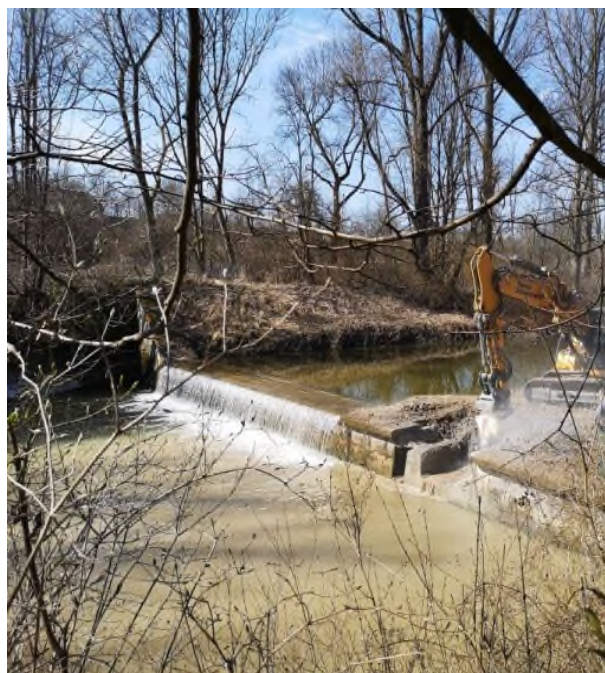
Abb. 2: Mit schwerem Gerät wird das untere Wehr in der Isen bei Winhöring abgefräst.
