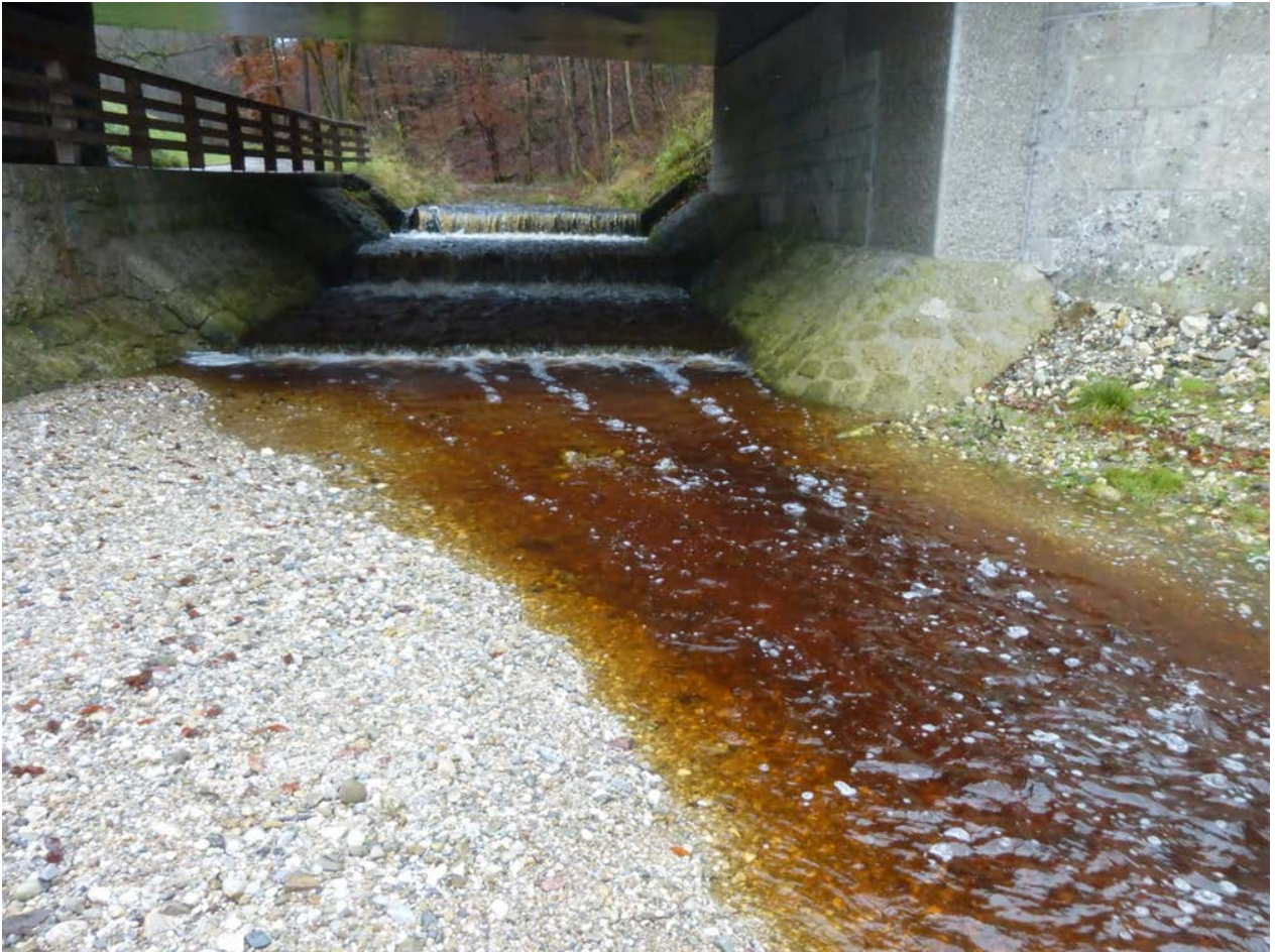
Abbildung 1: Schaumbildung an kaskadenartigen Absturz
